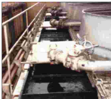
TORRES DE ENFRIAMIENTO
