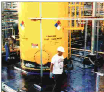
AREAS DE CONTENCIÓN DE QUÍMICOS
