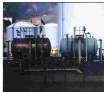
TANQUES DE ALMACENAMIENTO DE QUÍMICOS
