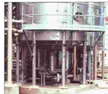
AREAS DE CONTENCIÓN DE QUÍMICOS
