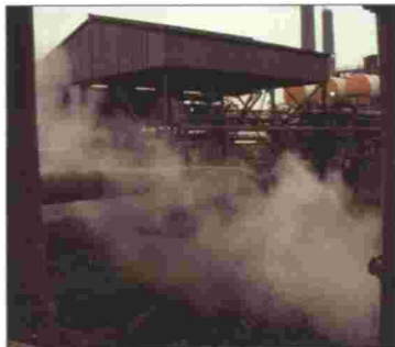
TUBERIAS DE VAPOR
