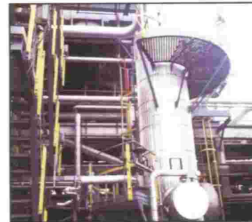
TORRES DE DESTILACION
