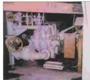
BOMBAS DE EXTRACCION DE CONDENSADO
