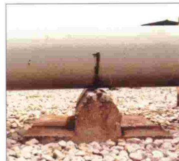
SOPORTES DE TUBERÍAS
