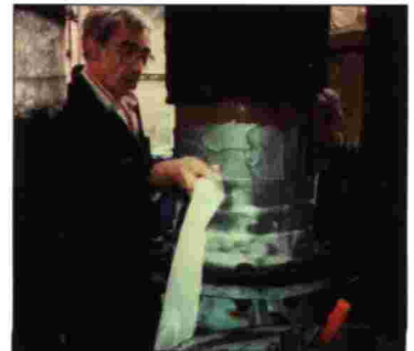
REPARAR TUBERIAS CORROIDAS
